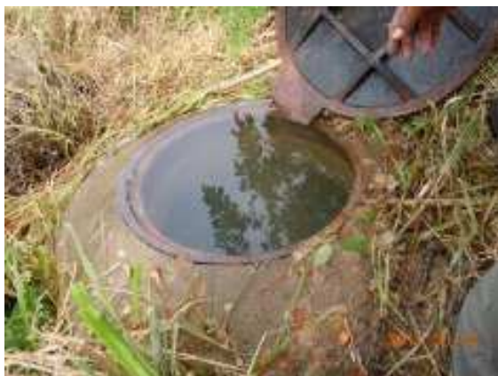
空気弁（室）からの漏水状況
