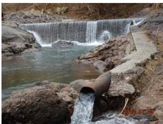
ブアブア取水ダム（導水管破損）
