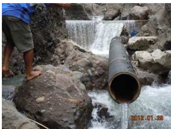
ナラウ取水ダム（写真の右上の転石による取水口破損と導水管破損）
