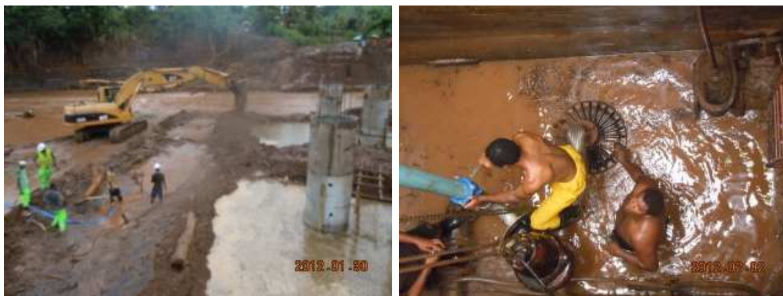
水道管敷設工事（左）と橋梁修理工事（右） 取水ポンプ井清掃作業（バラジバ取水場）
